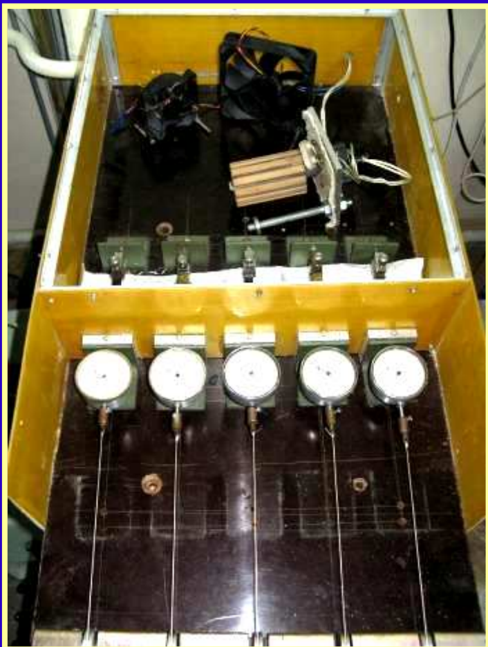
Загальний вигляд установки
